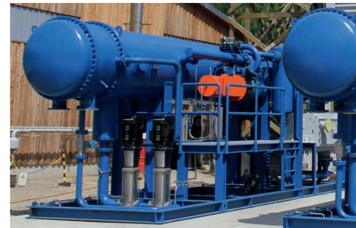
Kraftwerksmodule an der Forschungsplattform Groß Schönebeck
